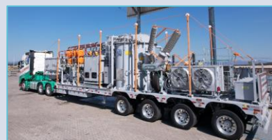
Subestação Móvel Digital
