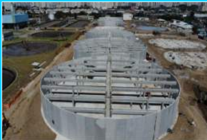
Parque Novo Mundo WWTP
