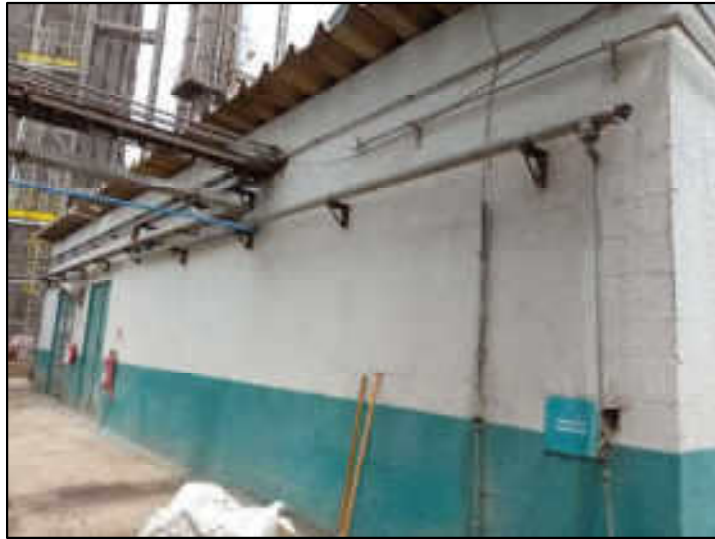
Sala de ar comprimido
