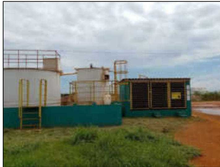
Tanque de combustível e área de reúso de água
