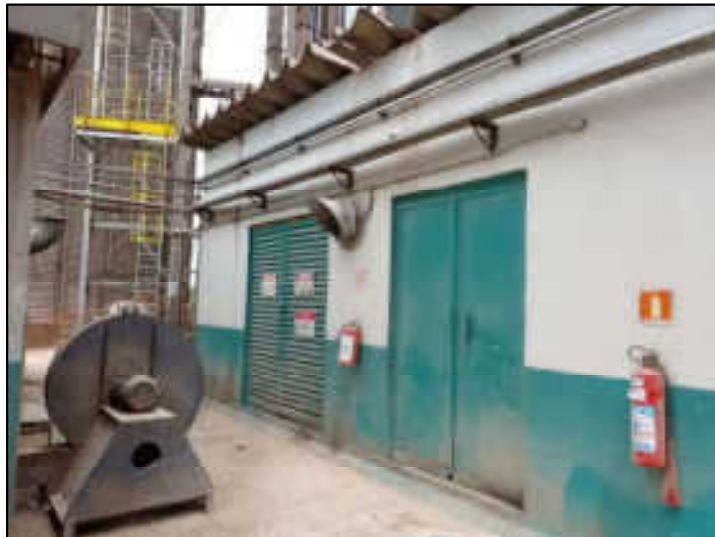
Compressores e CCM
