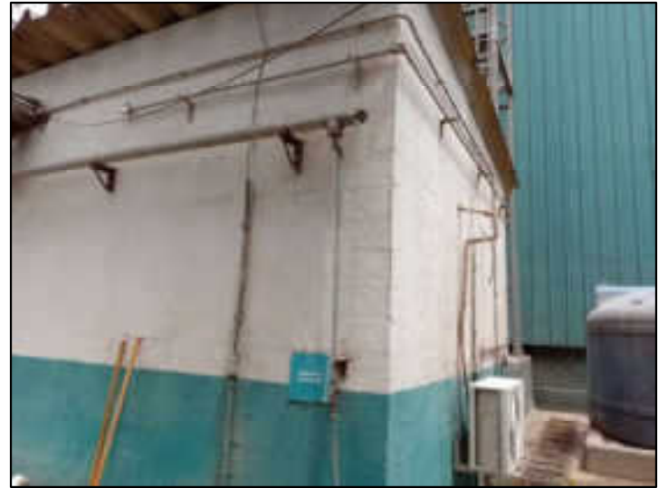
Sala de ar comprimido
