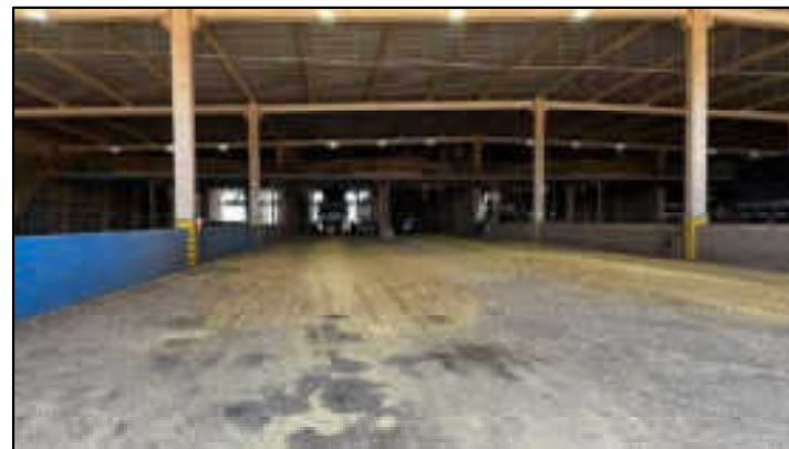
Moega e tombador de recebimento
