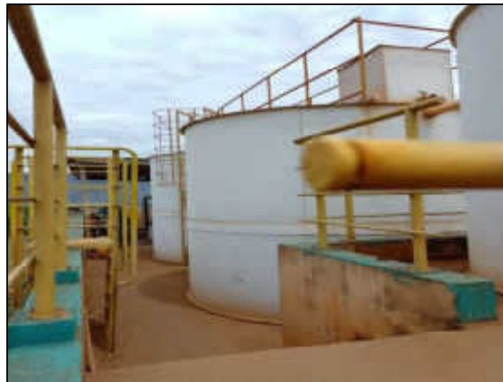
Tanque de combustível
