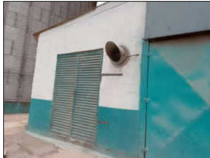
Compressores e CCM
