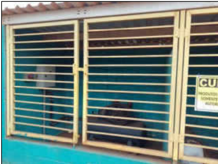
Área do compressor
