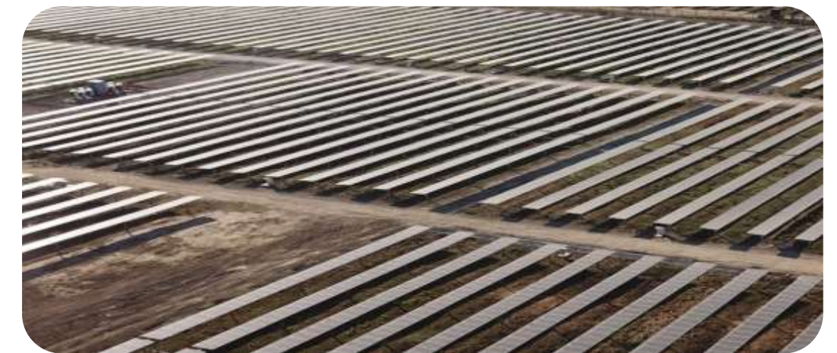
Usina fotovoltaica em Minas Gerais
