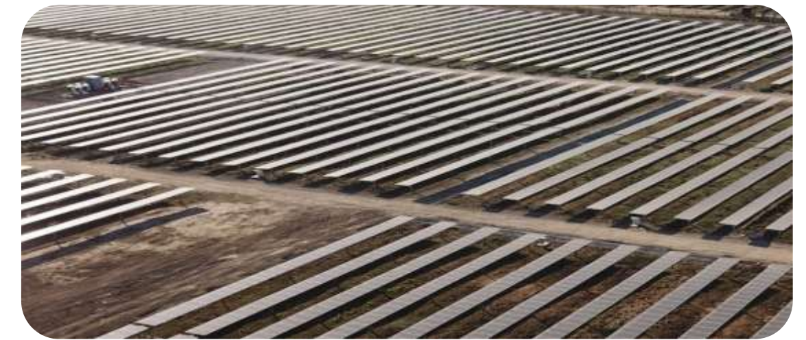
Usina fotovoltaica em Minas Gerais
