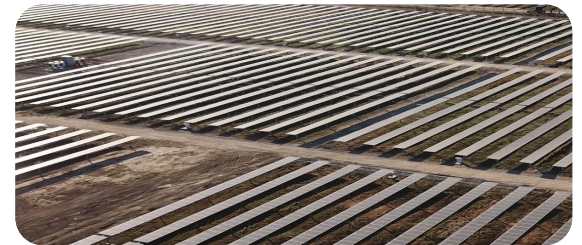
Usina fotovoltaica em Minas Gerais
