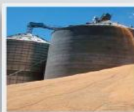
Colapso na Infraestrutura
