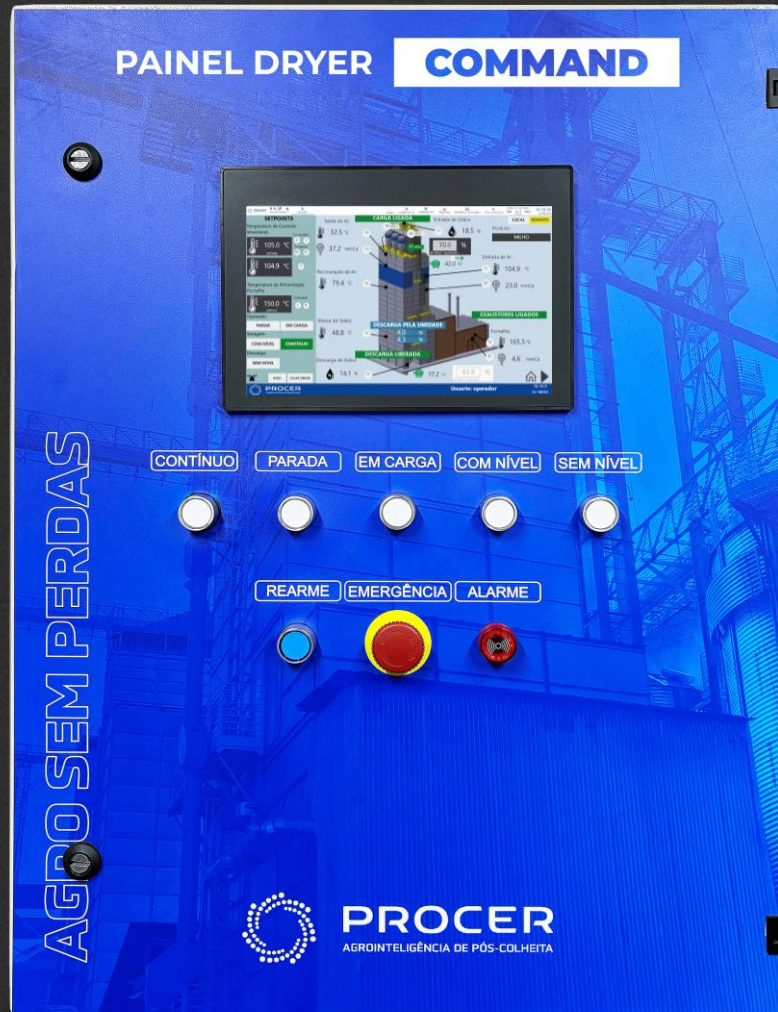
QUADRO ELÉTRICO DE COMANDO
