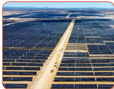
Complexo Solar Futura I - BA
