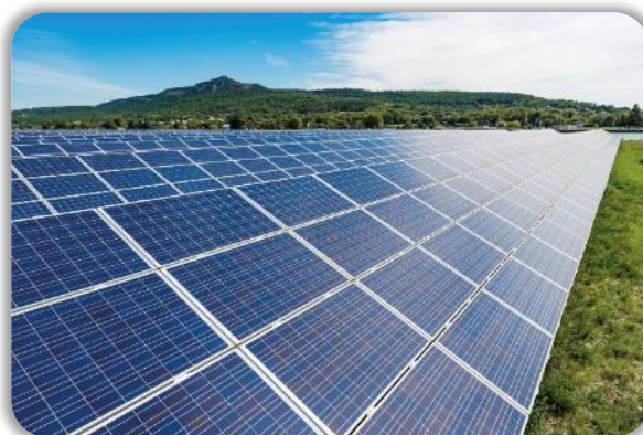
Sistema instalado pela EGSD.
