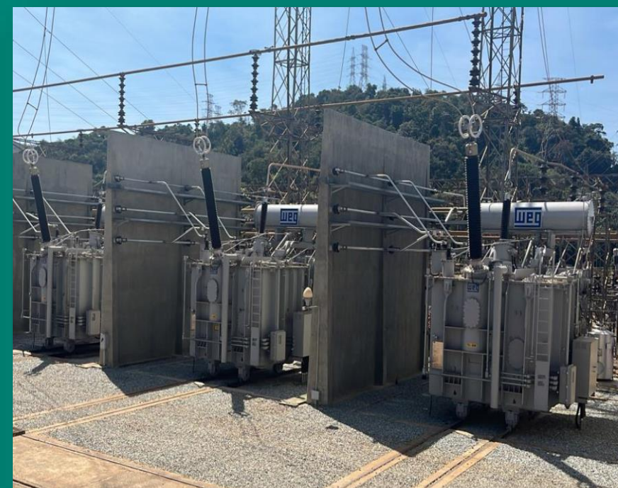
SE Taquaril – novos transformadores
